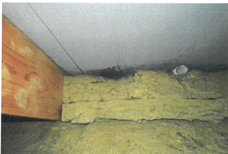
Foto 8, kondensvand på undersiden af undertaget (det mørke område) mod stien/indgangen.
