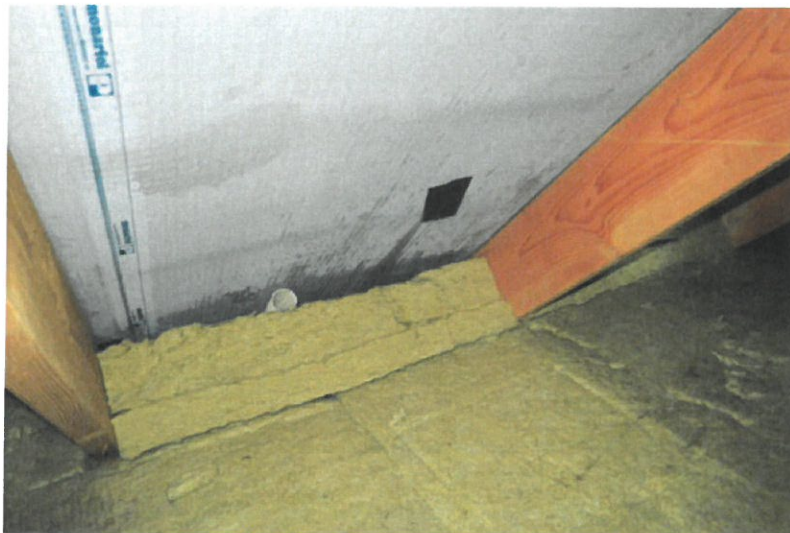
Foto 7, kondensvand på undersiden af undertaget (det mørke område) mod havesiden.
