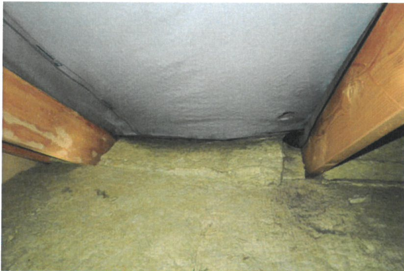
Foto 6, undertaget som hænger ned på isoleringen mod havesiden.
