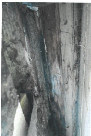
Foto 10, opfugtninger og skader på trækonstruktioner i tagudhænget, mod havesiden.
