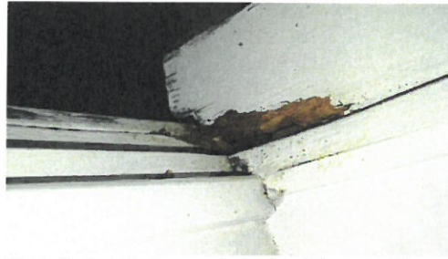
Foto 2, tagvindue med skader i karmstykket.
