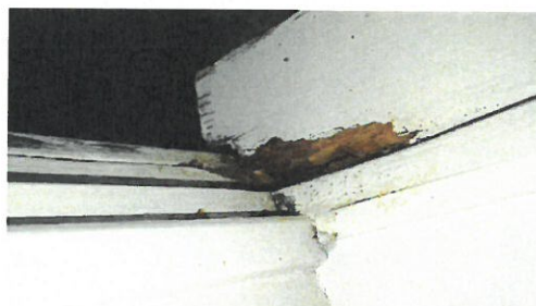
Foto 2, tagvindue med skader i karmstykket.
