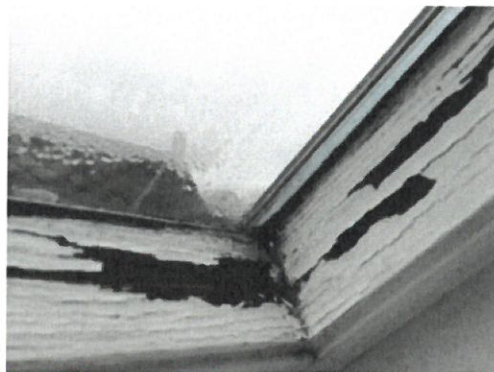
Foto 4, tagvindue med skader i karmstykket.
