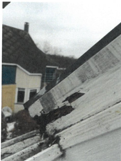
Foto 5, tagvindue med skader i karmstykket.
