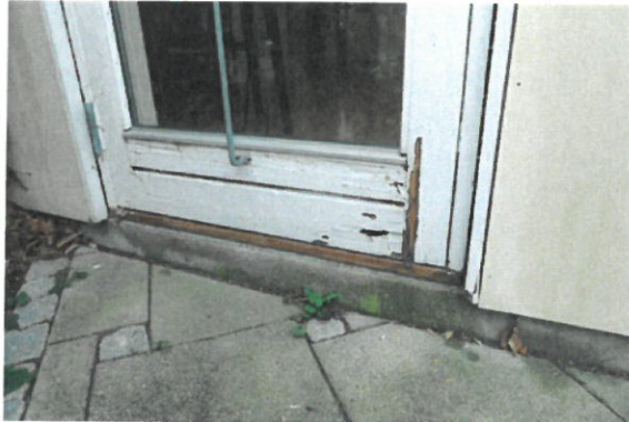
Foto 1, den undersøgte havedør med skader i dørrammen.
