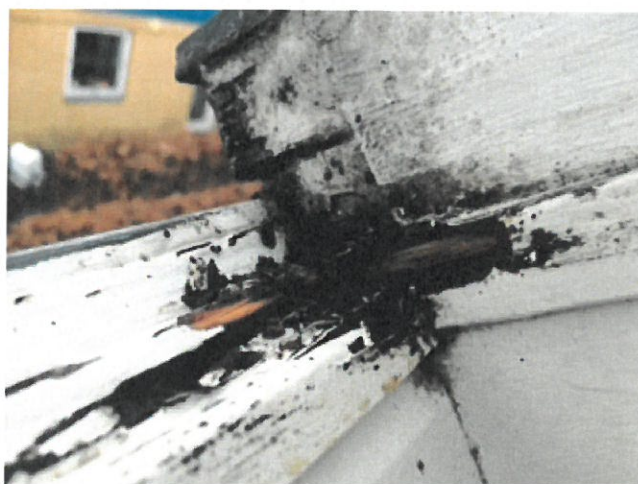
Foto 6, tagvindue med skader i karmstykket.
